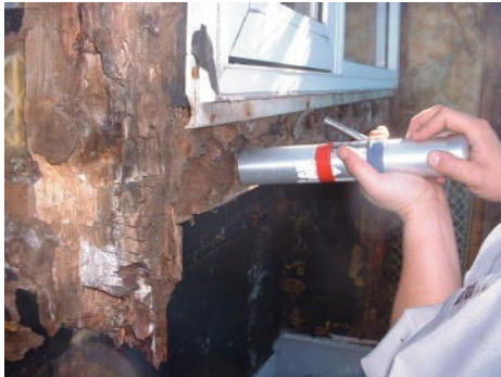
写真7 北面の窓枠部材 (出窓外側) ※腐朽が進み部材が崩壊している
