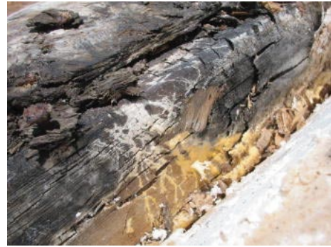
写真5 屋根の棟木に発生した褐色腐朽
