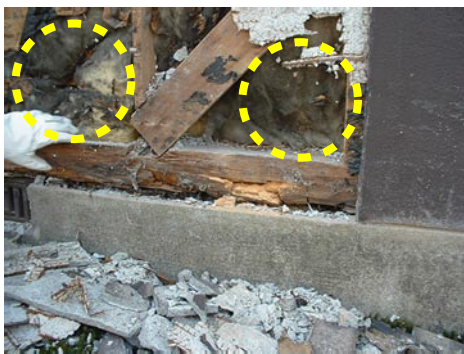
写真4 水回り（流し）下の土台 ※部材の崩壊とグラスウールの黒色化（点線）が観察される
