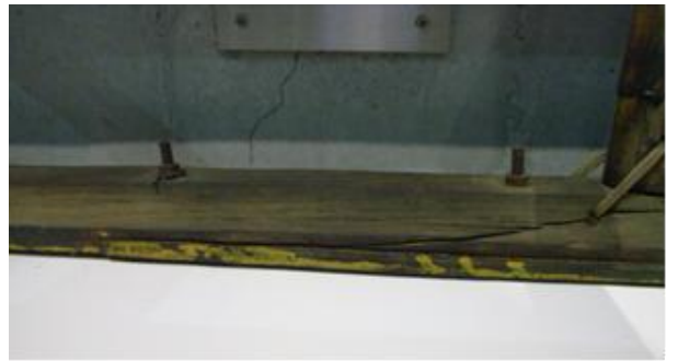
写真6 スカーフ接合部の修理の跡
