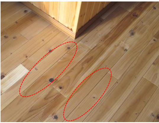
写真5 フローリングの幅方向目開きの例
