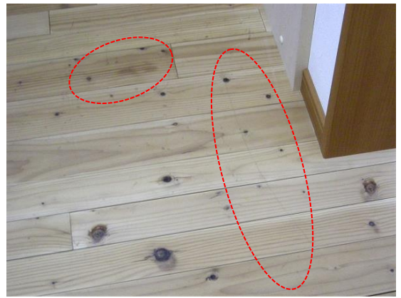
写真6 床の傷や汚れなど
