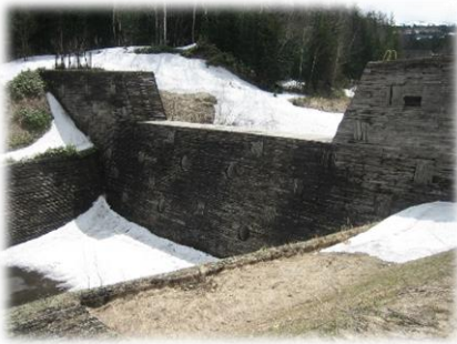
砂防ダム(木製化粧パネル)
