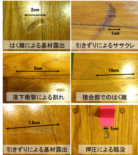
写真1 床損傷の例(施設1)
