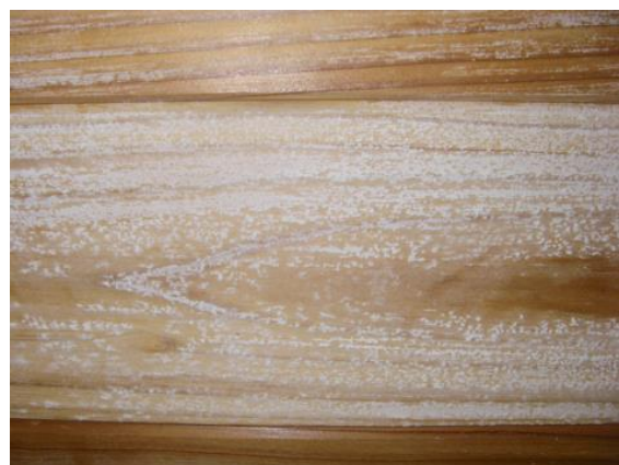
写真1 防火木材に発生した白華の一例
