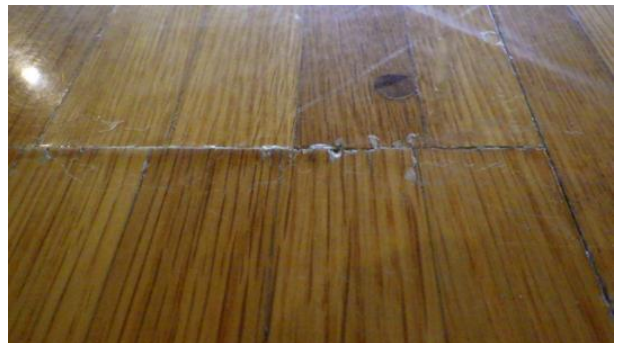
写真18 フローリング短辺側の端部の突き上げ
