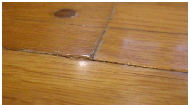
写真16 吸湿膨張による目地の段差
