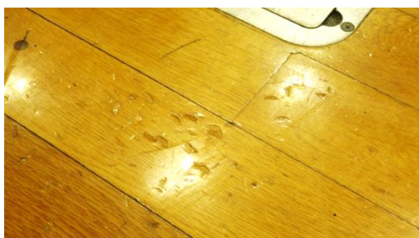
写真2 ポール差し込み穴周りの凹み
