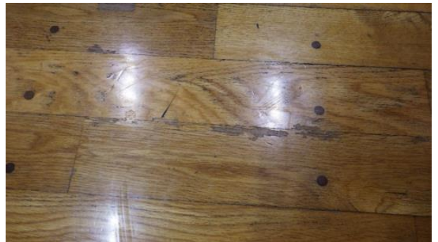
写真8 ラインテープを剥がした際の塗装剥がれ
