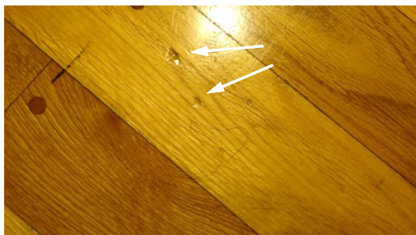
写真1 落下物による凹み
