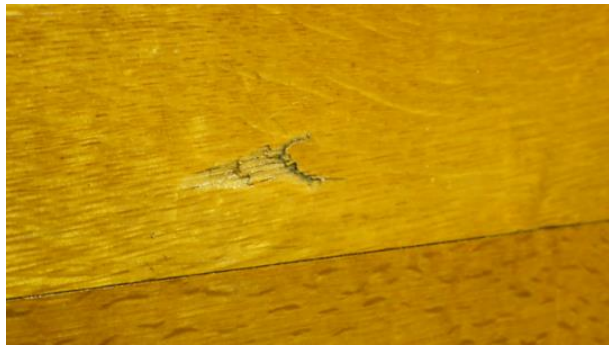
写真5 ササクレ状になった基材のはく離
