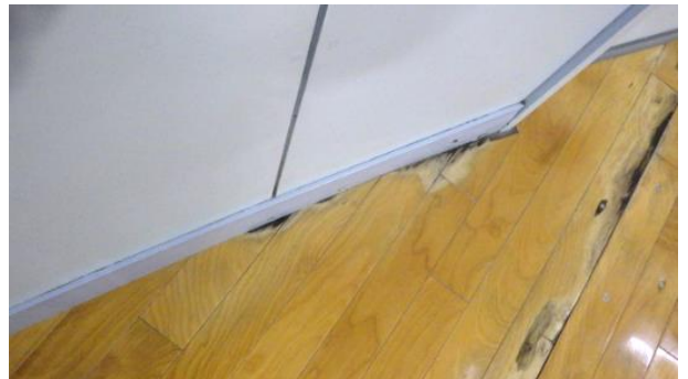
写真22 結露水による劣化
