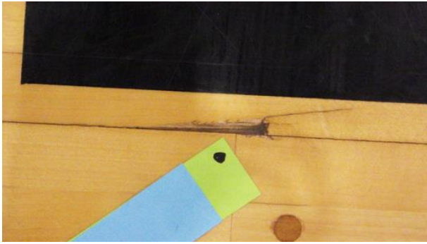
写真19 吸湿膨張による割れと欠け
