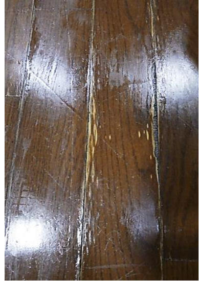
写真21 水拭きによる劣化
