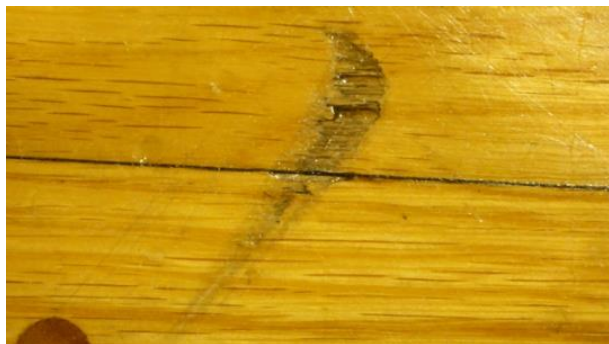
写真6 引きずりによる基材の露出
