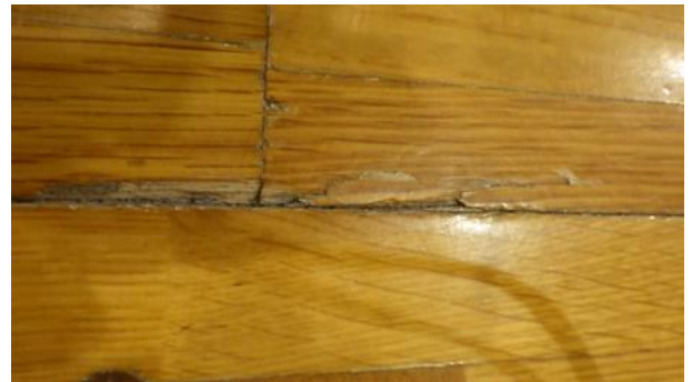
写真17 吸湿膨張による目地の割れと欠け
