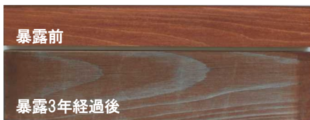
図1 含浸形木材保護塗料の劣化の一例
