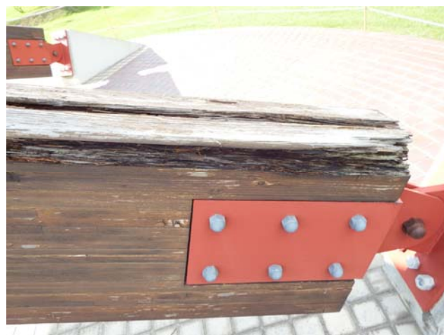
図3 脚部の腐朽（2017年）
