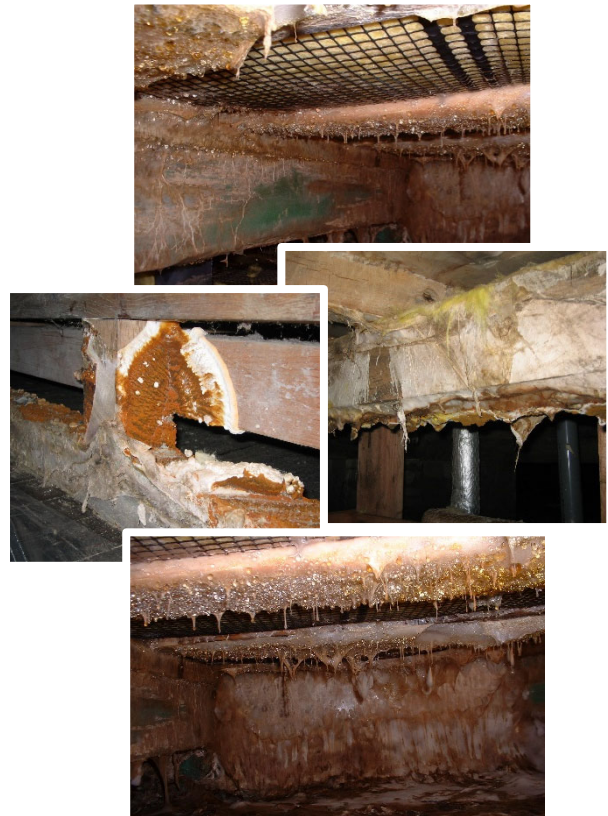
写真2 床下で腐朽菌が蔓延した事例
