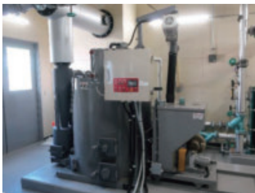
(b) ペレットボイラー
