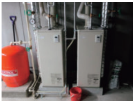
(d) 灯油ボイラー
