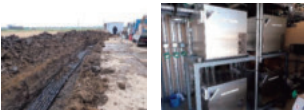
横引き配管の設置 ヒートポンプの設置 写真 3-3-3-4 配管，ヒートポンプ設置の設置状況
