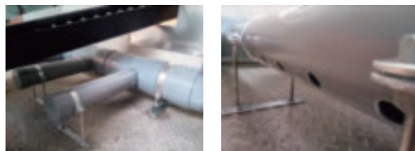
写真 3-2-3-(1)-6 送風乾燥システムと吹き出し口
