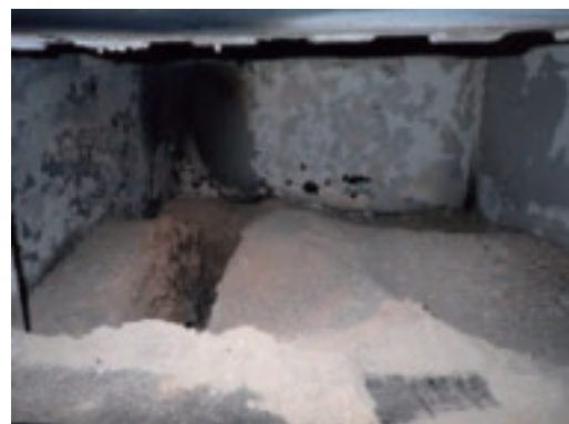
写真 3-2-3-(3)-3 2次燃焼室内での灰堆積状況
