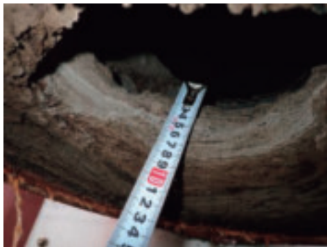
写真 3-2-3-(3)-5 煙道に堆積した水分混じりのダスト
