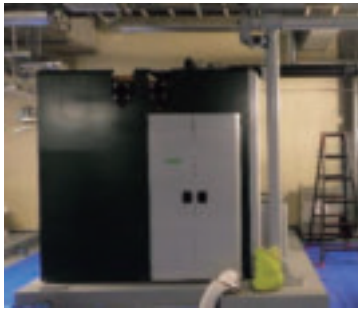
写真 3-2-3-(2)-1 木質バイオマスボイラー
