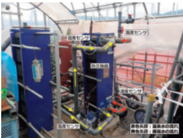
図 4-1-3-14 11号棟内部にあるプレート式熱交換器の全景（左側は未利用）
