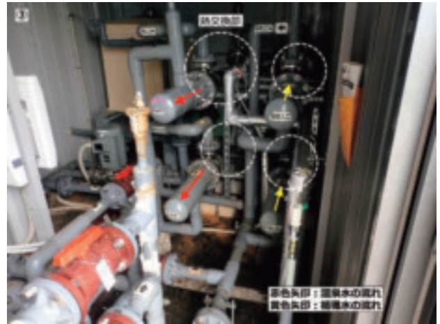
図 4-1-3-6 熱交換棟内部の全景（丸枠が熱交換部）
