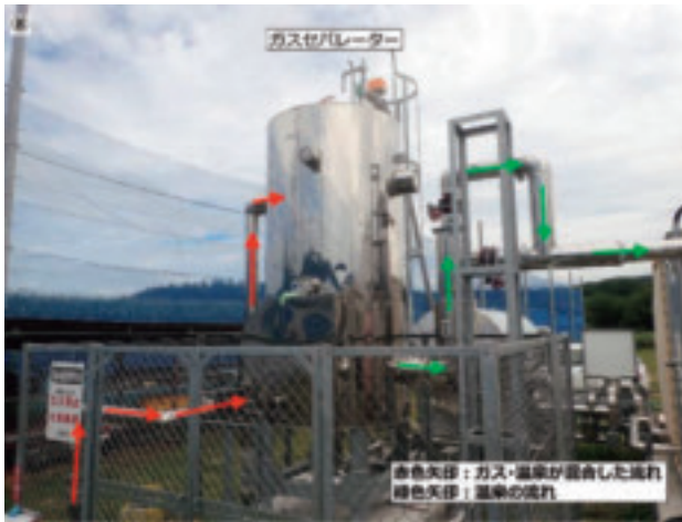
図 4-1-3-12 ガスセパレーター
