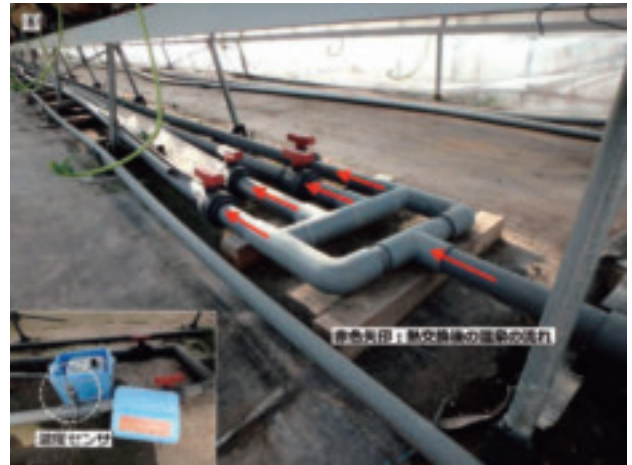
図 4-1-3-7 ハウス床面に敷設された熱交換後の温泉水が流れる塩ビ管
