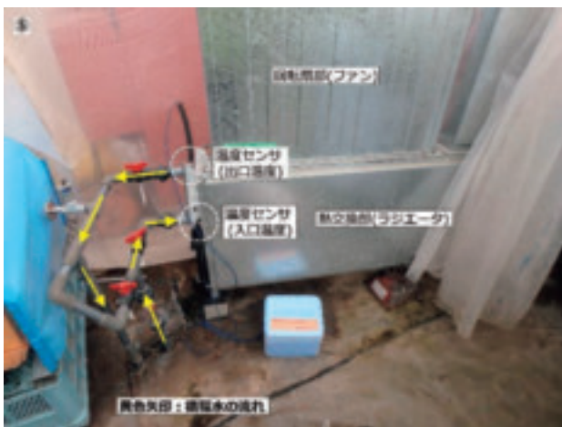
図 4-1-3-9 ファンコイルユニットの全景
