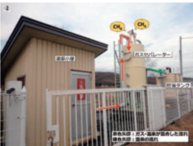
図 4-1-3-5 新町 1 号井がある源泉小屋，ガスセレーター，貯湯タンクの位置関係
