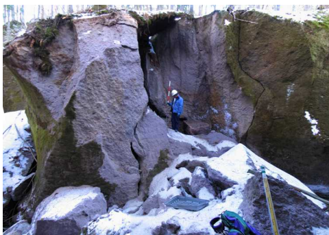
樽前山山麓の三の沢で発生した岩盤崩落
