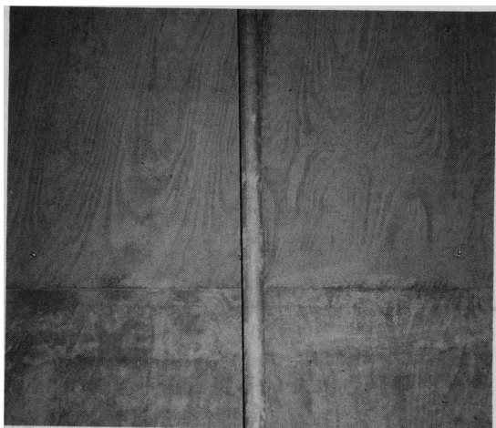
写真5 コンクリート面に写った木目
