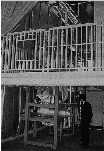
連続加熱処理装置
