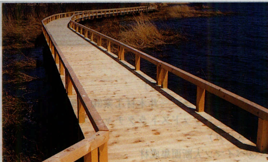
ウォークボード（木床舗装：デッキ状タイプ） 達古武キャンプ場（釧路町） 丸善木材(株) エゾ・トドマツ AAC系防腐剤加圧注入 釧路町 1993年（写真提供：丸善木材(株)）
