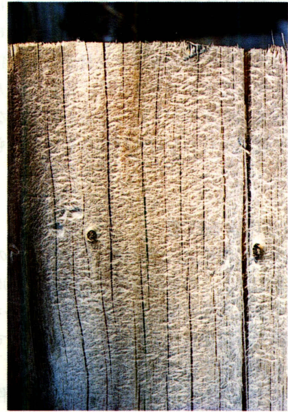
写真3 劣化した丸太表面
