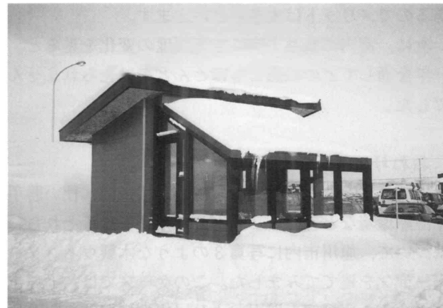
写真2 降水量23.5mmの翌日の屋根面の状況(1月)
