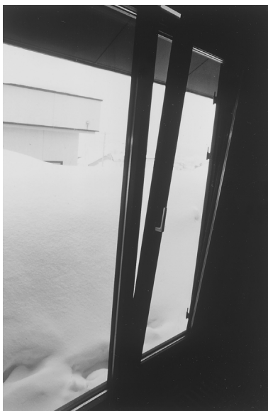
写真2 ドレーキップ窓 （内倒しの状態）
