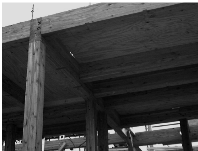
写真3 構造用集成材を用いた住宅の骨組み
