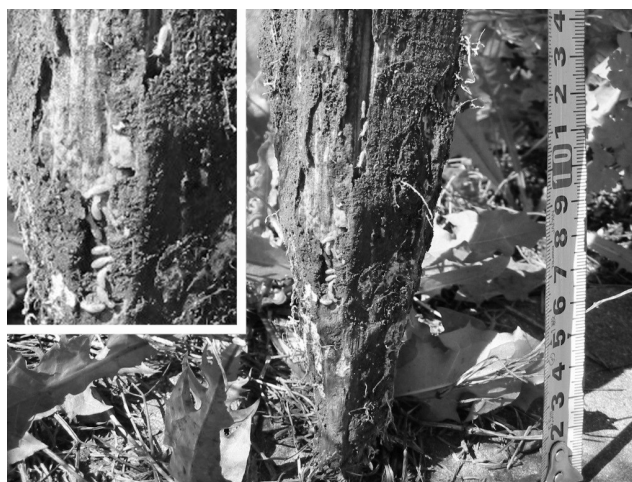
写真3 シロアリによる杭材の被害 (平成13年 名寄)
