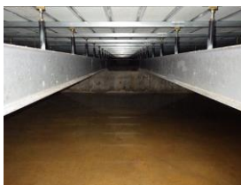
第 1 図 基礎部分での浸水
