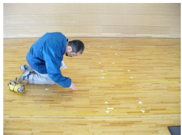
第 2 図 フローリング損傷部位の調査
