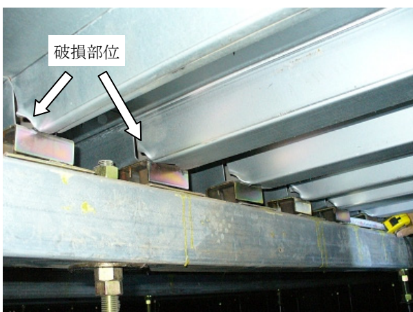
第 1 図 耐荷重仕様運動床での構成部材破損例
