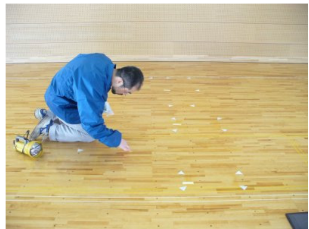
第 2 図 フローリング損傷部位の調査
