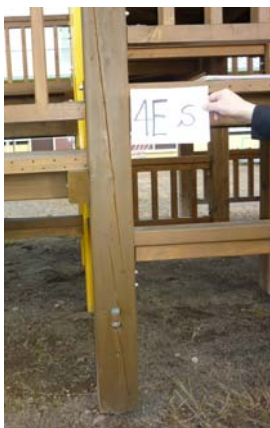
←第 1 図 試作遊具の劣化調査
