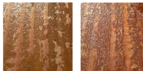
第 2 図 冬季に暴露を開始し、3 ヶ月後における塗膜 （淡色の部分で塗膜が剥離している）
