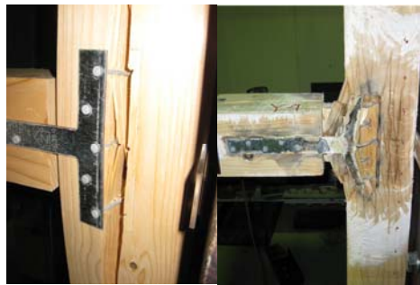
第 2 図 破壊形態の例 右：健全試験体、左：腐朽試験体
