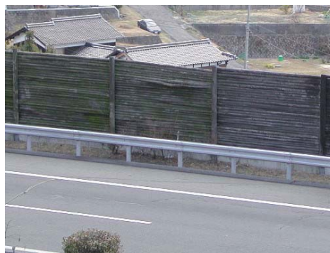
第2図 木製防音壁の劣化状況
