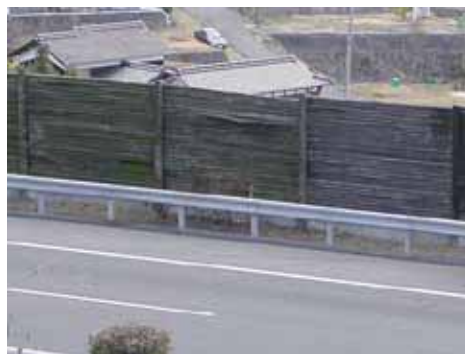
第 2 図 木製防音壁の劣化状況
