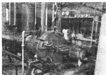
木材防腐注薬装置
