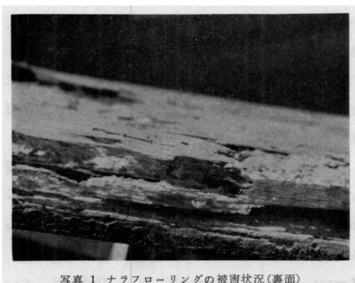
写真1 ナラフローリングの被害状況(裏面)
