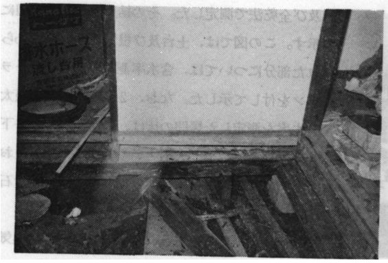
第5図 土台材の腐朽状態
