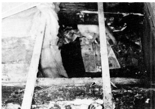
写真 29 イドタケによる大引(▶)の被害状況 Photo.29. The damage of the beam (▶) by C. puteana.
