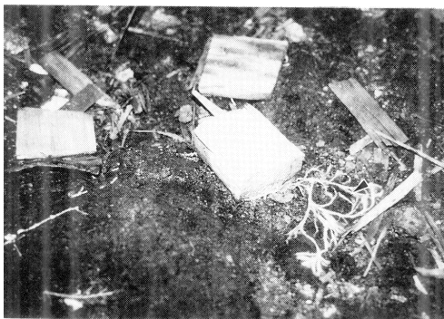
写真30 床下に放置された残材からの菌糸生長 (▶) Photo.30. Hyphal growth (▶) from the wood debris below the floor.
