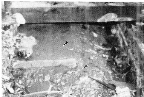
写真22 床下土壤表面に散乱した孢子( ) Photo.22. Spores ( ) on the ground below the floor .
