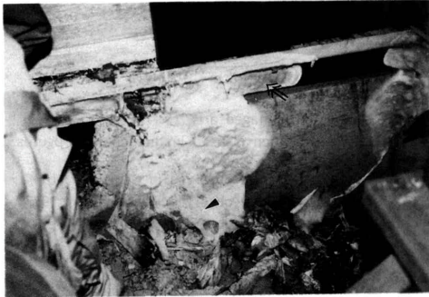
写真2 床下土壌面から布基礎を介して土台(○)へ生長した菌糸、菌糸束(▶) Photo.2. Hyphae and hyphal strand (▶) from the ground to the sill (○) via concrete foundation .
