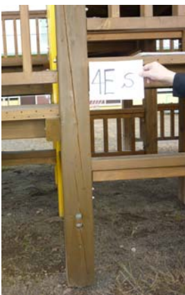
←第 1 図 試作遊具の劣化調査
