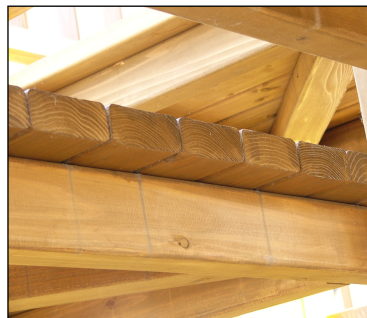
写真3-3 材と材の接触面
