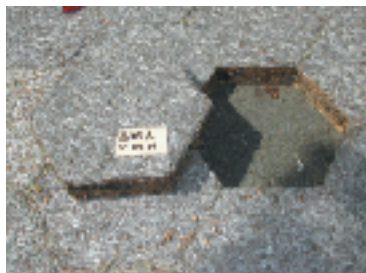
写真 10 施工後 2年経過時の高耐久型舗装ブロックの状況
