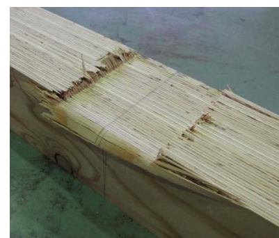
めり込み破壊の様子
