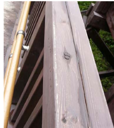
写真1-4-2 横木上面の割れ
