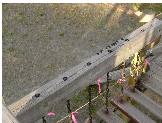
写真2 水平材上面の劣化
