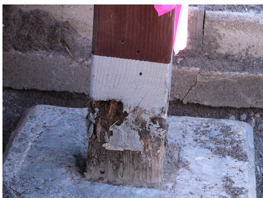
写真1 支柱の地際部の劣化
