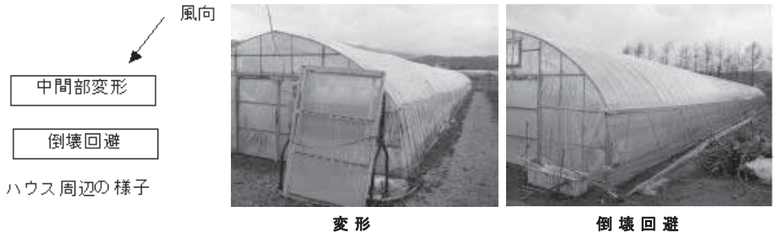
図IX - 5 変形および倒壊回避事例 (渡島中部)
