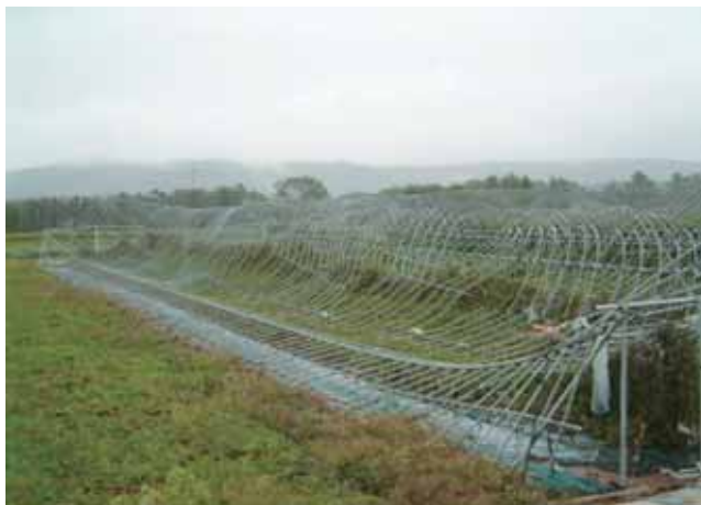
写真IX-1 倒壊事例 (北後志地区農業改良普及センター撮影)
