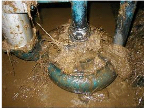
写真1 長草による受入槽破砕ポンプの閉塞
