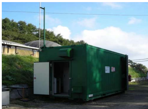
左：余剰バイオガス精製圧縮充填装置
