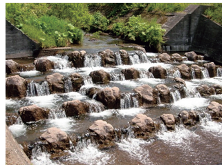
落差工に設置された魚道
