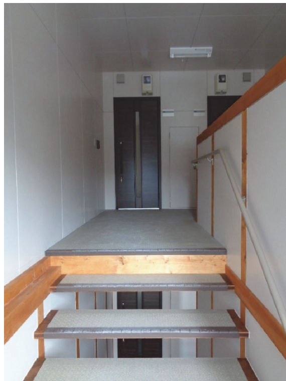
写真 5-4 防振階段の完成例
