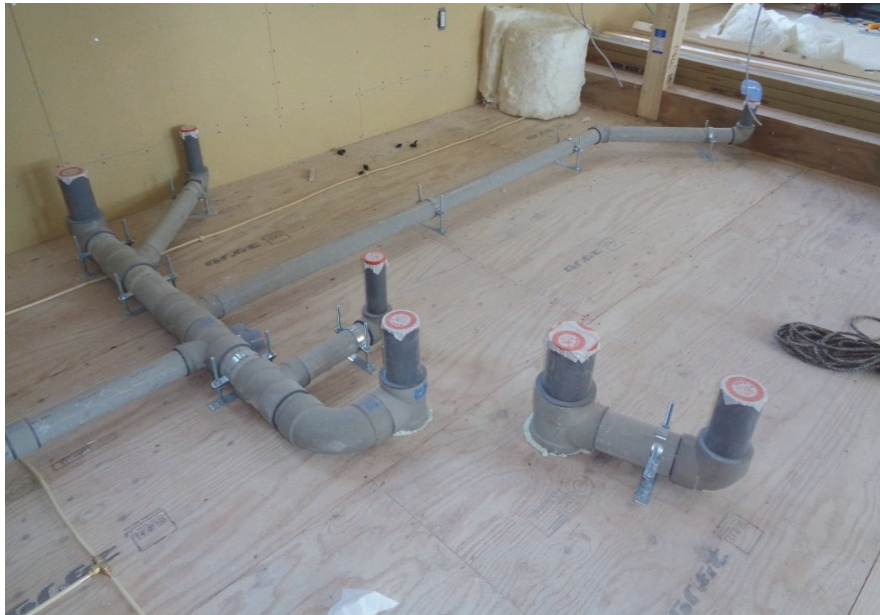
写真 5-2 乾式二重床部分への配管例
