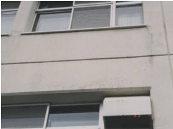
写真4 - 1 網目状のひび割れ
