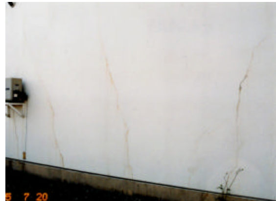
写真4 - 2 線状のひび割れ
