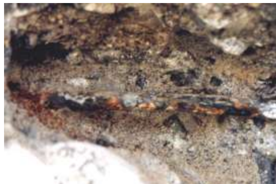
鉄筋腐食グレード C (断面欠損に至るさび)
