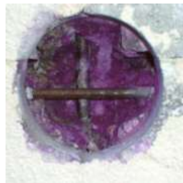
鉄筋腐食グレード A (部分的なさび)
