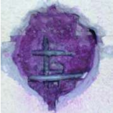
鉄筋腐食グレード A(鉄筋腐食なし)
