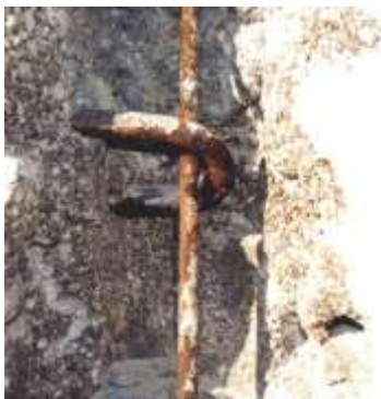
鉄筋腐食グレード B (全面的な浮きさび)
