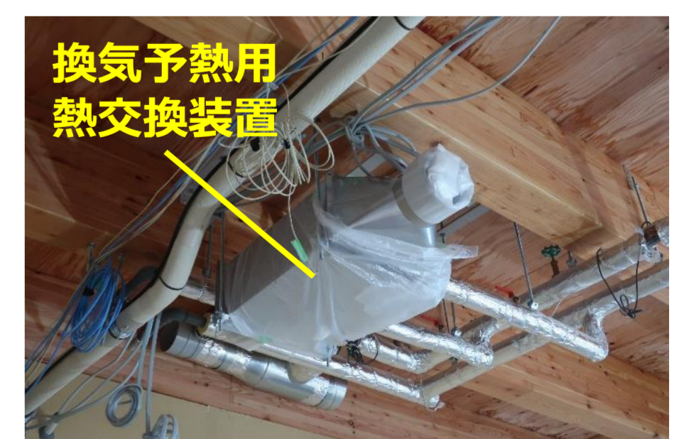
写真2 実装された熱搬送技術
