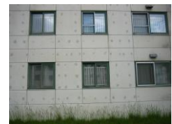
(b) アンカ箇所損傷
