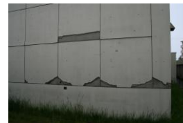
(a) 下地材の損傷
